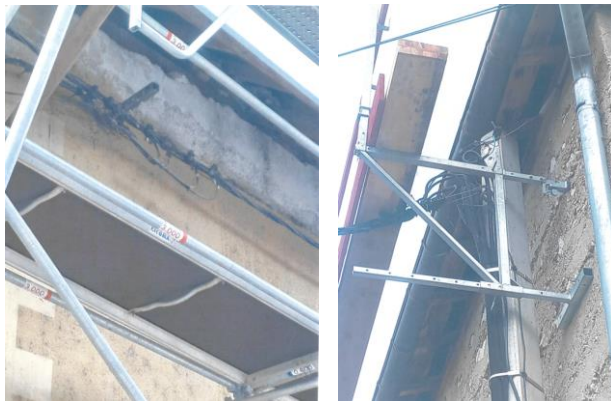
Nouveaux REX liés à des travaux en façades.
