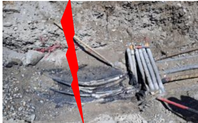
Intervention à proximité de câbles maintenus sous tension non protégés (bâche) en exerçant sur les accessoires un effort mécanique > Court-circuit + départ de feu
