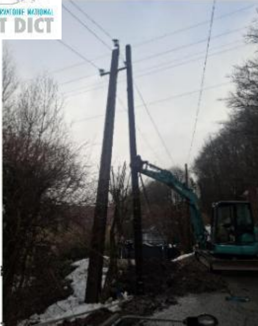
Implantation d'un support Télécom à proximité d'une ligne HTA
