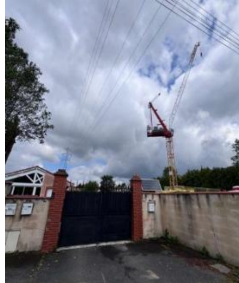
Le grutier est venu amorcer avec la phase 7 de l'ouvrage HTB. Le système d'interférence était défaillant tout comme le traçage de la zone d'interdiction communiqué. Lors de l'ICP le positionnement de la grue a été validé (contre l'avis RTE)
